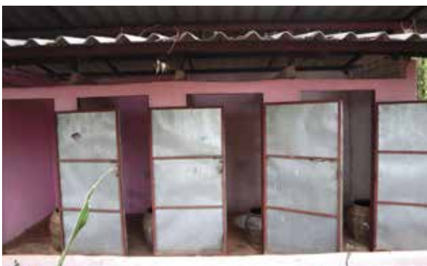
ห้องน้ำนักเรียนที่รอการซ่อมแซม
